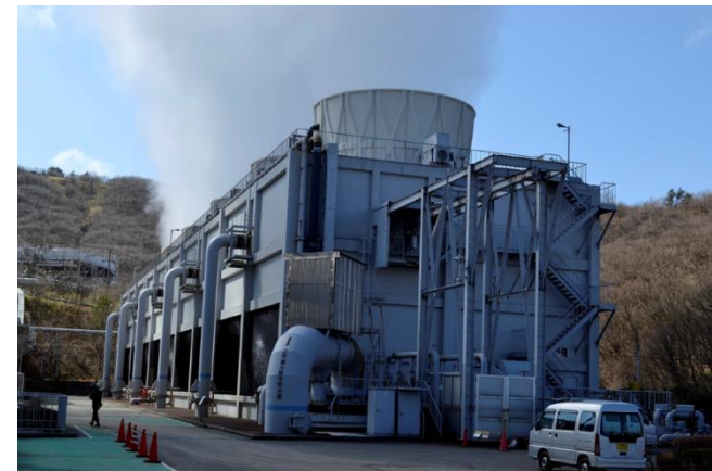
Elektrownia geotermalna Hatchobaru (Kyushu Electric Power), Japonia, 2015 Prototypowy generator termoelektryczny o mocy ok. 20 kW (informacja własna)
